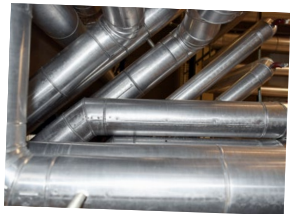
Warmwasserleitungen im Rohrkeller der ARA Elsau. Diese führen in den Faulurm und sorgen dafür, dass der Faulprozess einsetzen kann.
