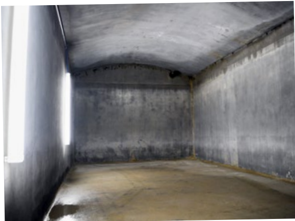
Das Reservoir Rätterschen wird mit Quellwasser gespiesen. Die Quelle ist sehr ergiebig und trocknet selbst im Sommer nicht aus.
