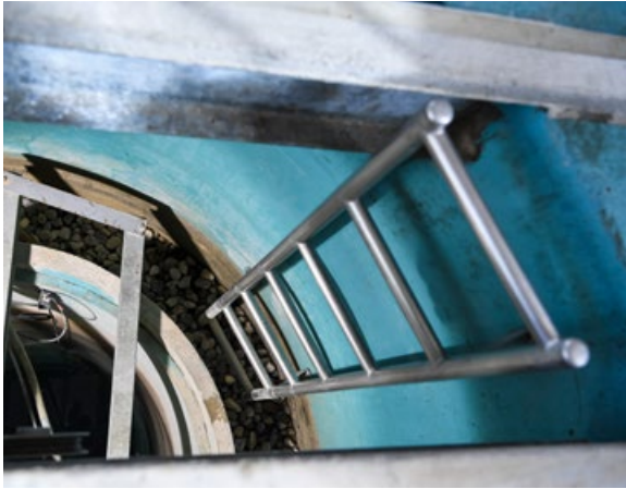
Pumpwerk Schottikon. Die Leiter führt zum Brunnen hinunter.
