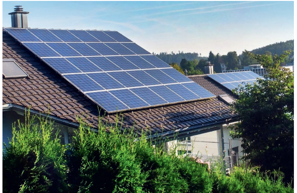
Die Produktion von Solarstrom ist beim Heizungsersatz oft eine gute Ergänzung.
