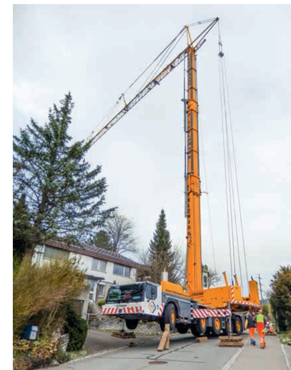
Der Kran versperrt die ganze Strasse und musste mit Balken unter den Abstützungen in eine sichere waagrechte Lage gebracht werden
