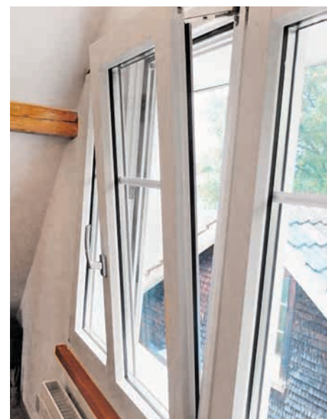
Mit einem offenen Kipfenster geht im Winter nur Wärme verloren, die Luft erneuert sich nicht
