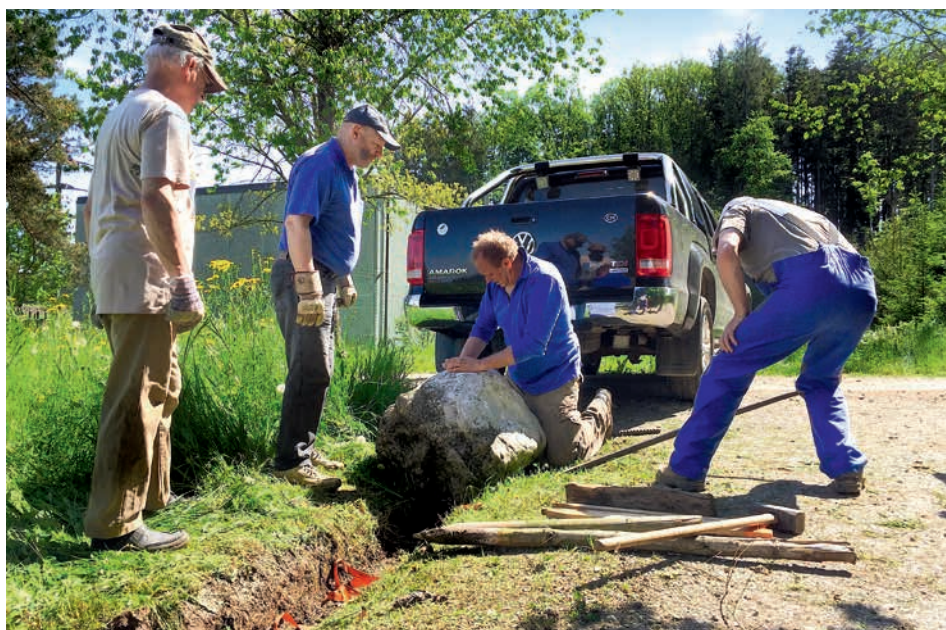
Muskelkraft und Motorenleistung: Ein «dicker Brocken» wird bei der Einmündung zum Zufahrtsweg platziert und schützt den frisch ausgehobenen Sickergraben vor Autofahrern, welche zu stark die Kurve schneiden.
