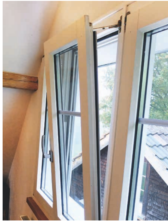
Mit einem offenen Kippfenster geht im Winter Wärme verloren. Die Luft erneuert sich nicht.
