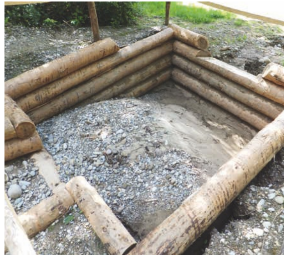
«Auffangbecken» Das Geschiebe bleibt hängen, doch die noch nicht verwachsenen Böschungen werden ausgeschwemmt
