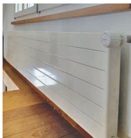
Alle Heizkörper müssen die Wärme frei abgeben können.
