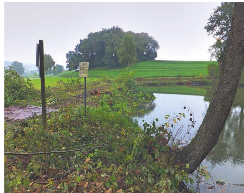
Der leer geholzte Damm. Bildmitte rechts der zu ersetzende Überlauf.
