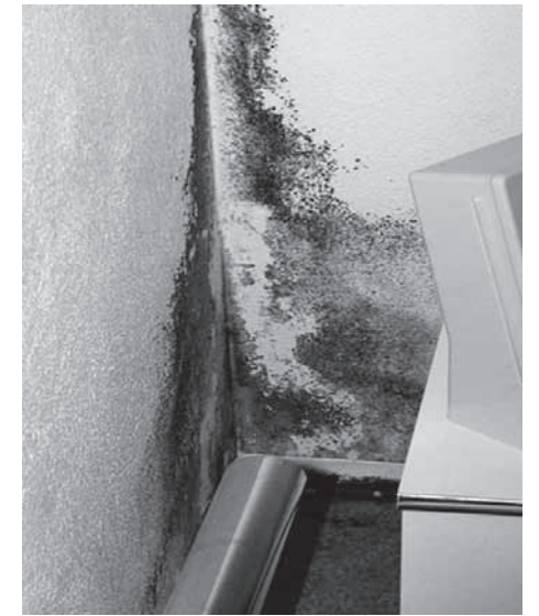
Schimmelpilz kann ganze Bauteile zerstören (Bild: Nova Energie GmbH Aarau).
