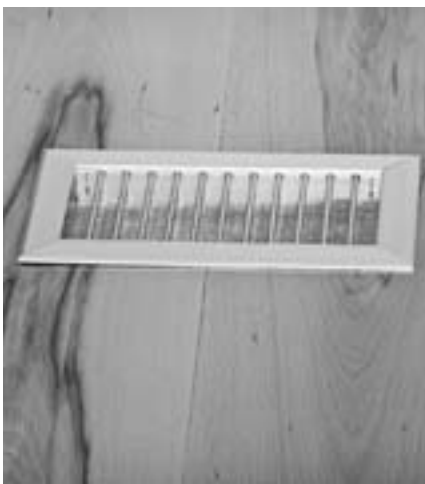
Die Lüftungsaustritte (hier im Boden)
