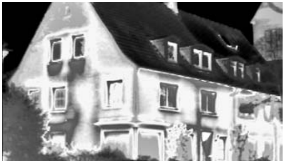
Aufnahmen mit der Wärmebildkamera helfen, Wärmebrücken am Haus zu entdecken
