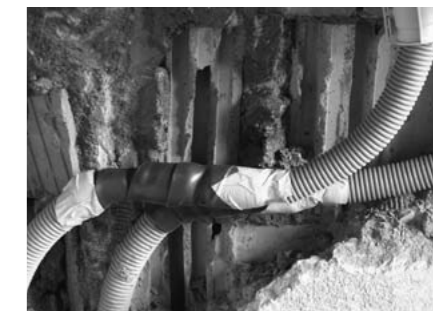
Werden Leitungen mitten in der Wand zusammengefügt, kann dies später zu schweren Wasserschäden am Gebäude führen.
