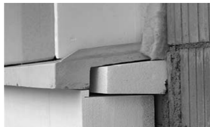
Solch mangelhaft verlegte Isolation führt später zu Folgeschäden an der Fassade.
