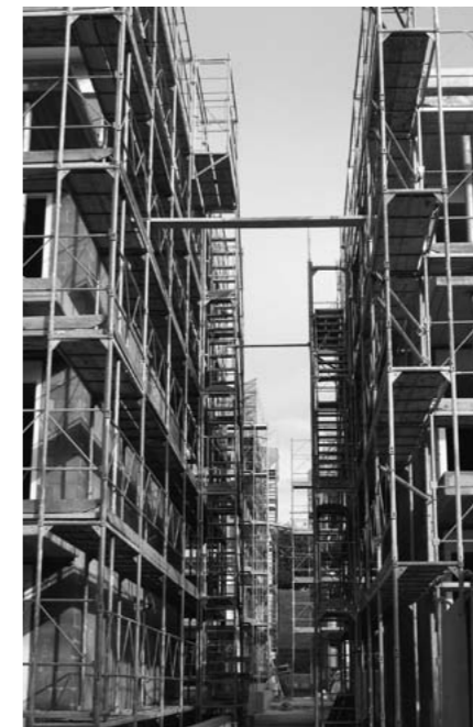
Auch die Unfallrichtlinien der Suva wurden auf der Baustelle Heidenbüel oftmals nicht eingehalten, wie diese halbsprecherische «Brücke» zeigt.
