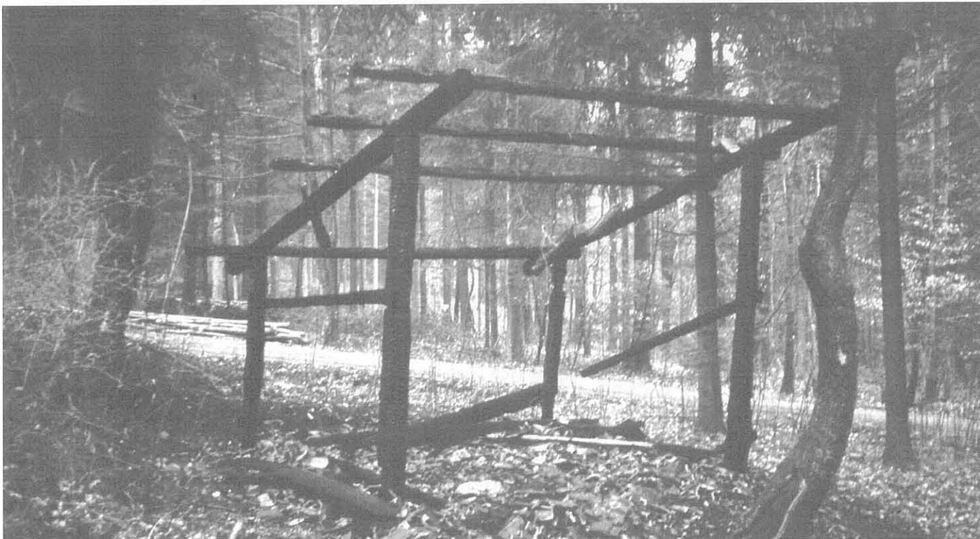
Die einstige «Waldhütte» nach dem Brand 1993
