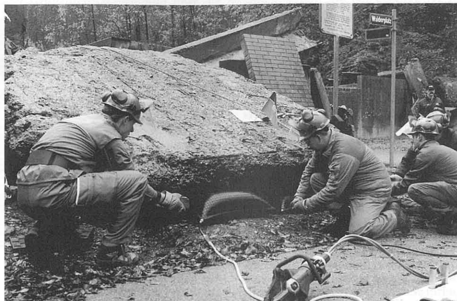
Mit den Hebekissen der ZSO Elsau-Schlatt können bis zu 40 Tonnen schwere Trümmer bewegt werden.
