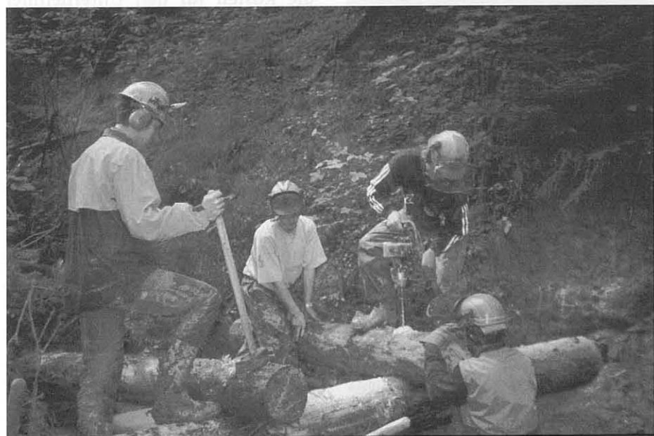
Damit das Wasser keine andere Möglichkeit mehr hat, wurden Flügelzangen aufgesetzt. Vorgebohrt und mit Armierungseisen zusammengenagelt, versehen diese Bachschwelle über 30 Jahre ihren Zweck.
