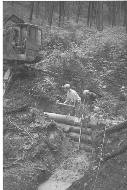
Die tiefen Gräben und die schweren Lasten wurden mit dem Schreitbagger ausgehoben oder bewegt.
