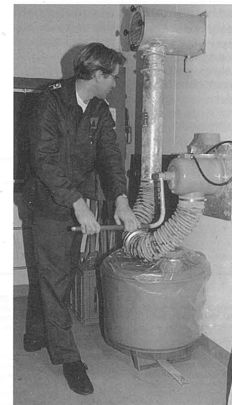
Die Belüftungseinrichtungen können auch ohne Strom für gute Luft im Schutzraum sorgen.
