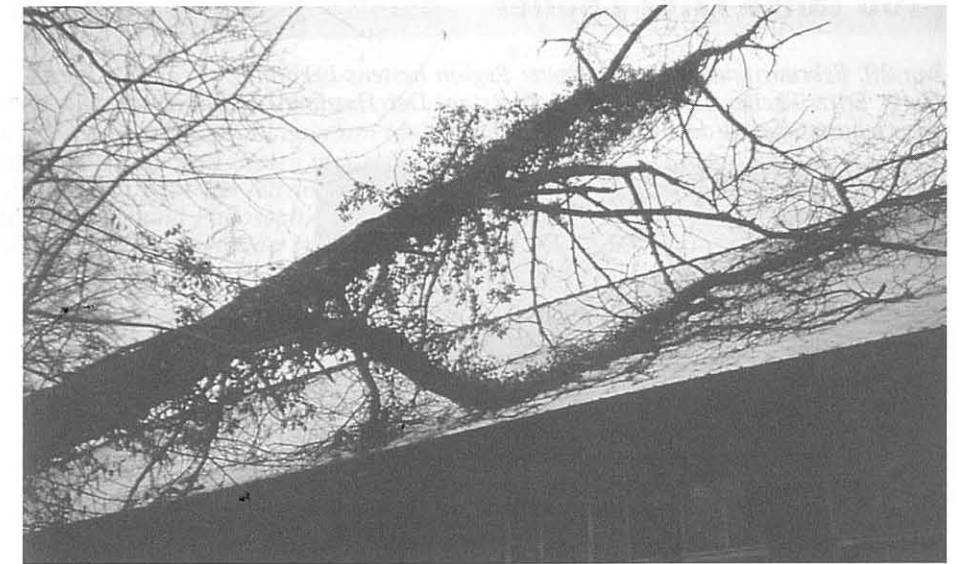
Der Schnee wurde zur Last – nur das Gebäude verhinderte dass der Waldkirschbaum ganz umstürzte.
