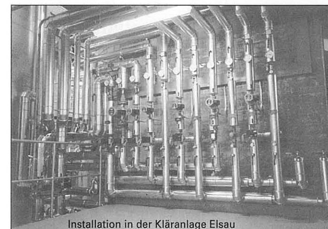
Installation in der Kläranlage Elsau
