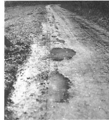
Das Bankett ist zu hoch – es bildet sich eine Pfütze. Ein Schlagloch entsteht. Jeder weicht aus, so dass es immer grösser wird.
