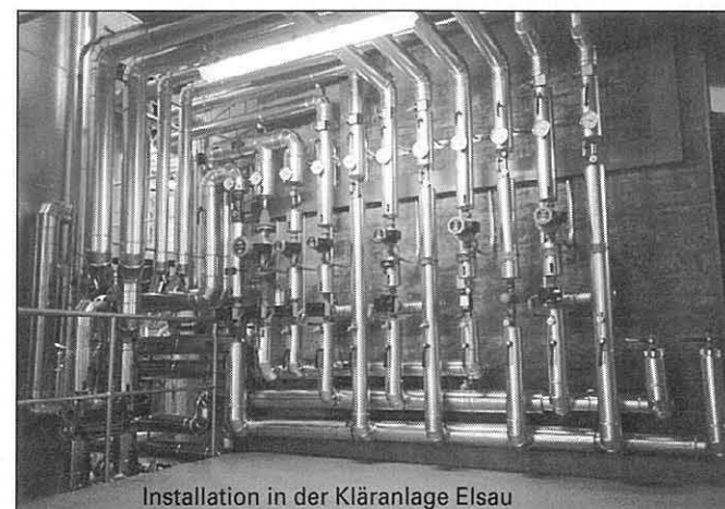
Installation in der Kläranlage Elsau
