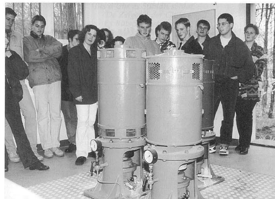
Einblick in die Wasserversorgung der Gemeinde am Beispiel des Pumpwerks Schottikon: Technik zum Anfassen.
