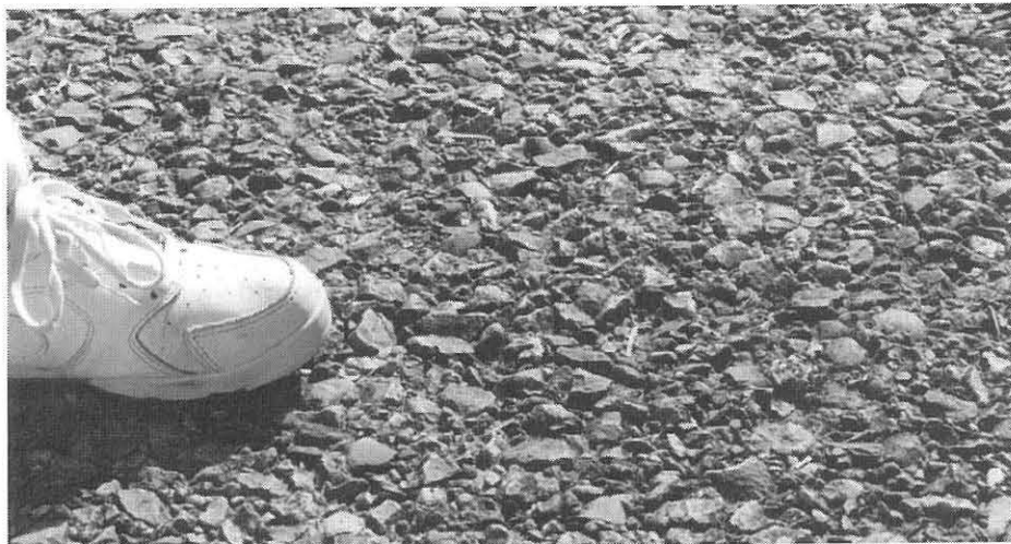
Grobe, scharfkantige Steine als Fahrbelag eines Veloweges.
