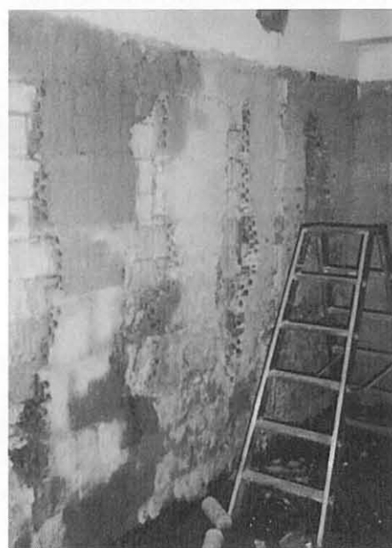
Duschraumwände hinter dem Verputz
