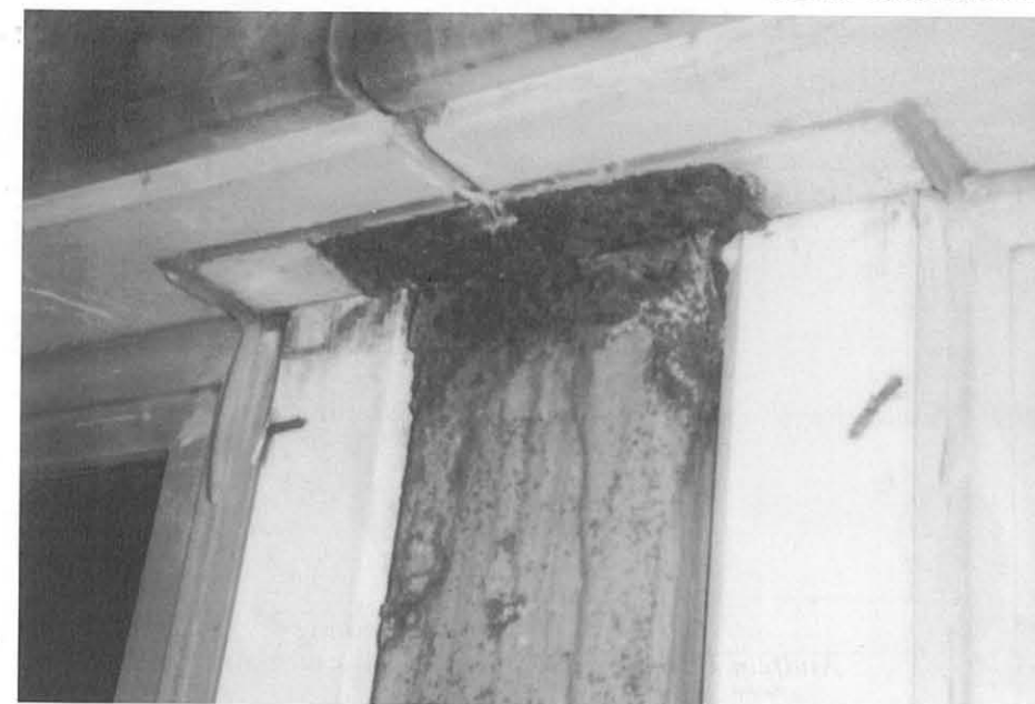
Eine der rostbefallenen Stützen an der Aussenwand der Mehrzweckhalle.
