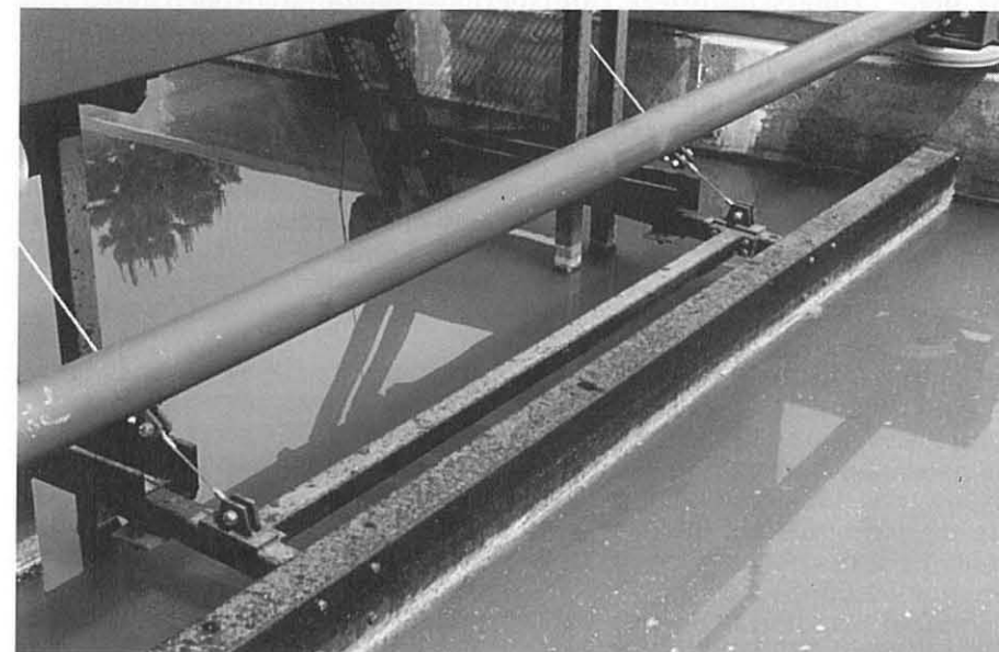
Räumer im Vorklärbecken
