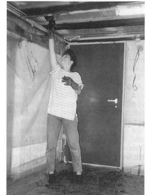
Zum Streichen der Balken fehlt die Leiter...
