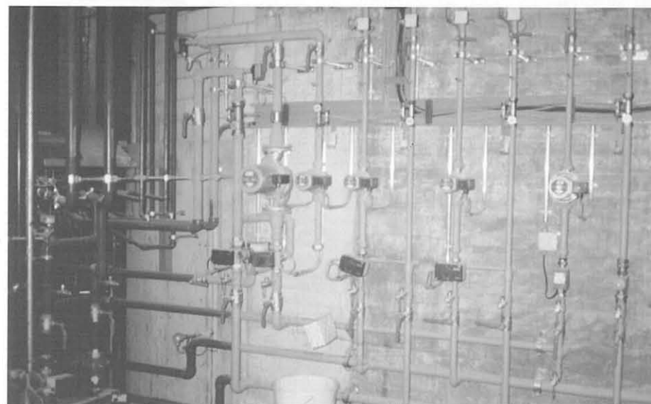
Verteilbatterie der Heizung
