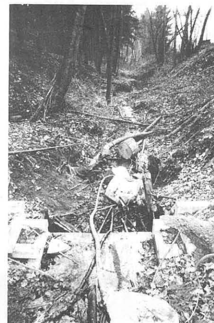
Von Unrat und groben Holzstücken befreien: der Tobelbach
